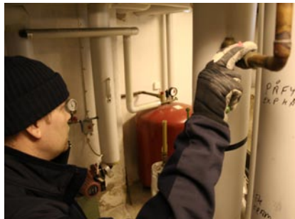
Det måste vara tryck i radiatorsystemet för att varmvatten ska kunna tryckas hela vägen upp i höga hus. Mattias fyller på det röda expansionskärlet.
